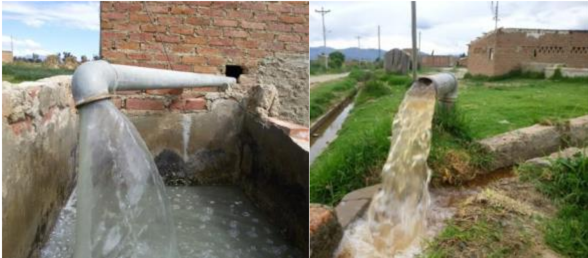
Figura 15. Pozos de bombeo con arrastre de sedimentos
